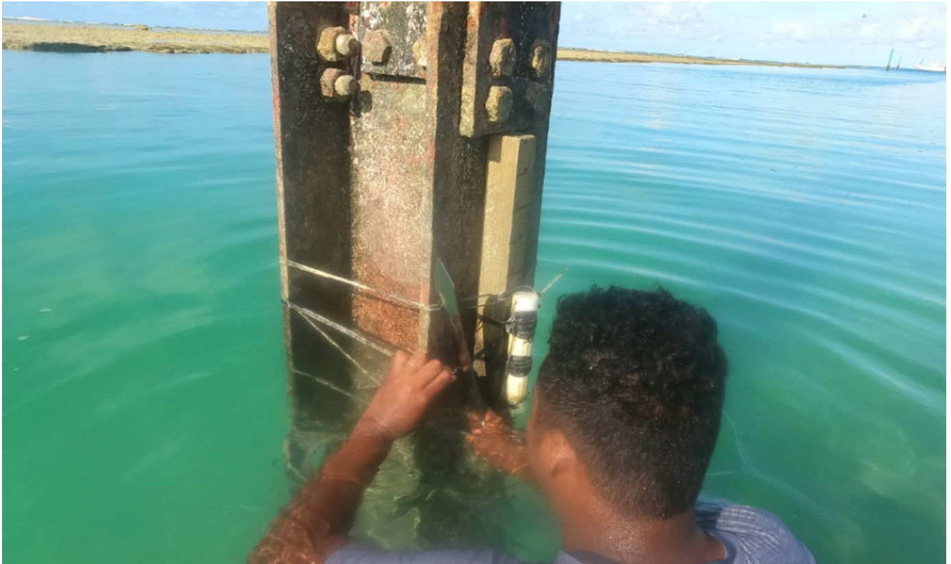
Figure 10: Exemple d'installation d'un capteur de pression pour surveiller les niveaux d'eau à Nui, Tuvalu.
